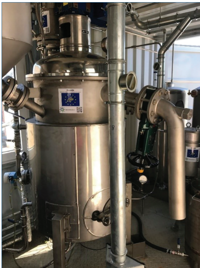
Fig. 3 - Reattore trattamento fisico
